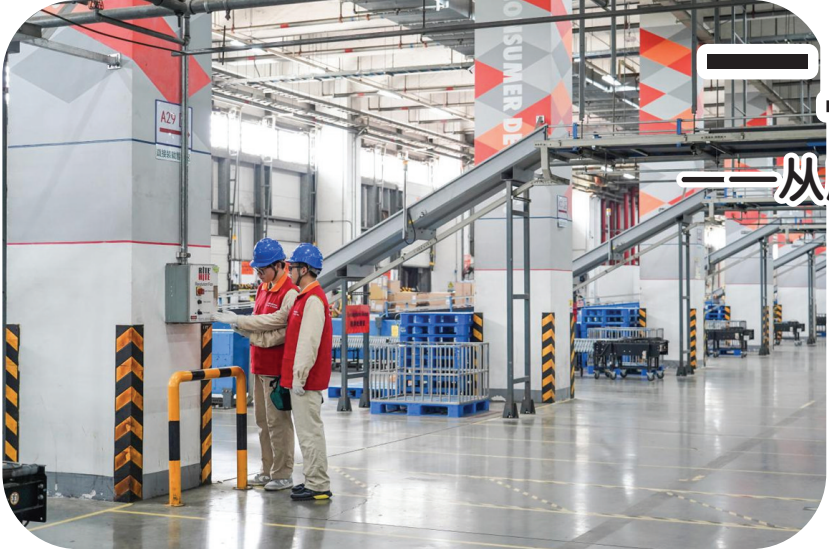
图为国家电网江苏电力电暖流党员服务队队员赴耐克中国零碳智慧物流园,对物流作业区及全自动无人立体仓库用电情况进行全面检查。
