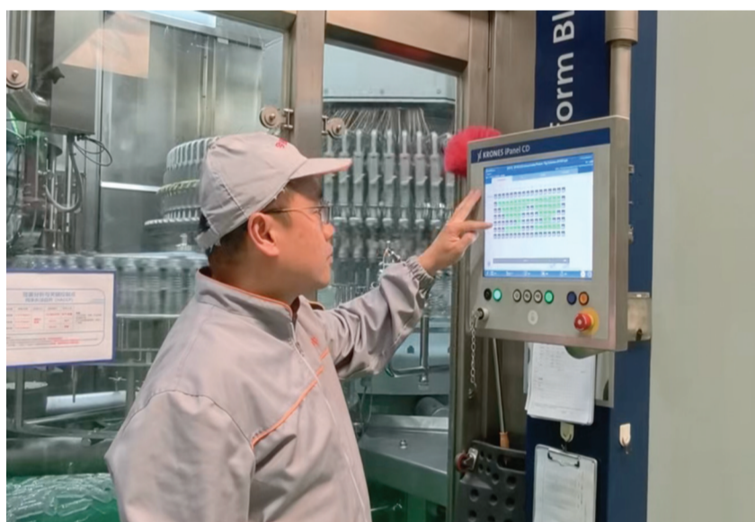
图为今麦郎饮品(晋中)有限公司设备科工程师在检查、调整吹瓶机工艺。受访者供图
