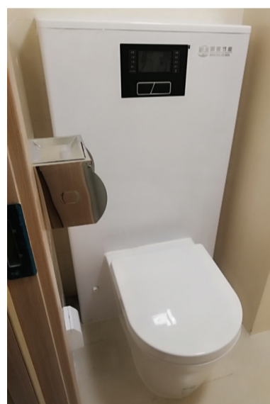
每户配有中水循环处理设备
